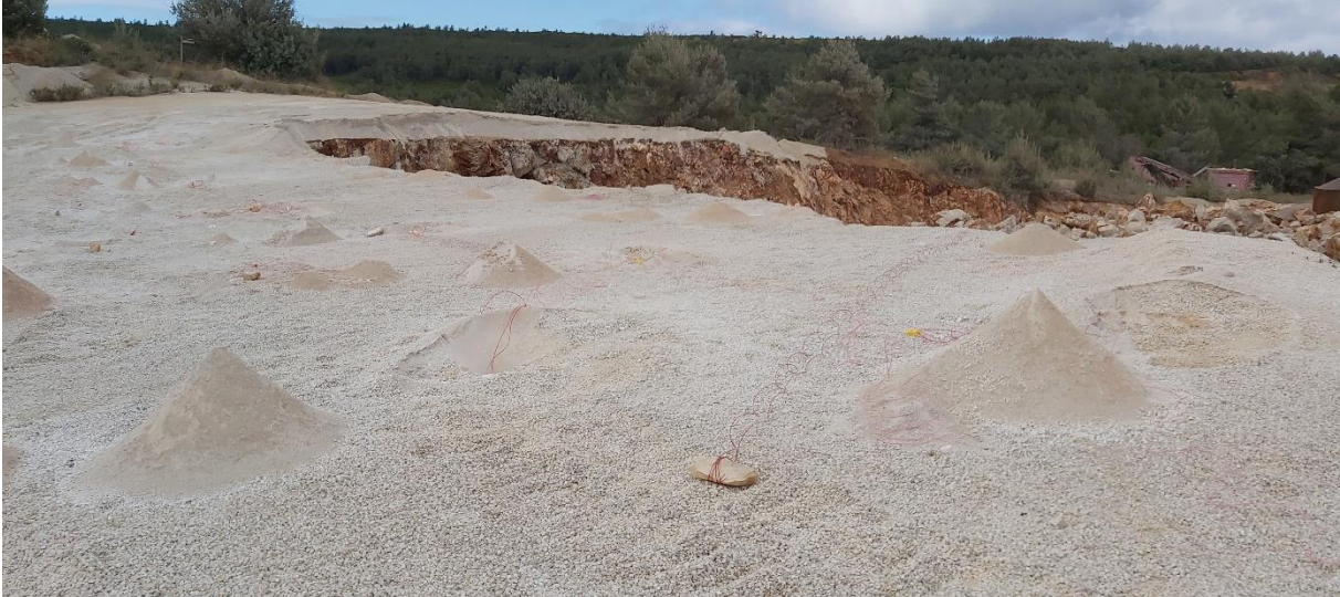
Figura 44 - Desmorte nº 81.21 da pedreira do Vale do Covão imediatamente após o carregamento dos furos
